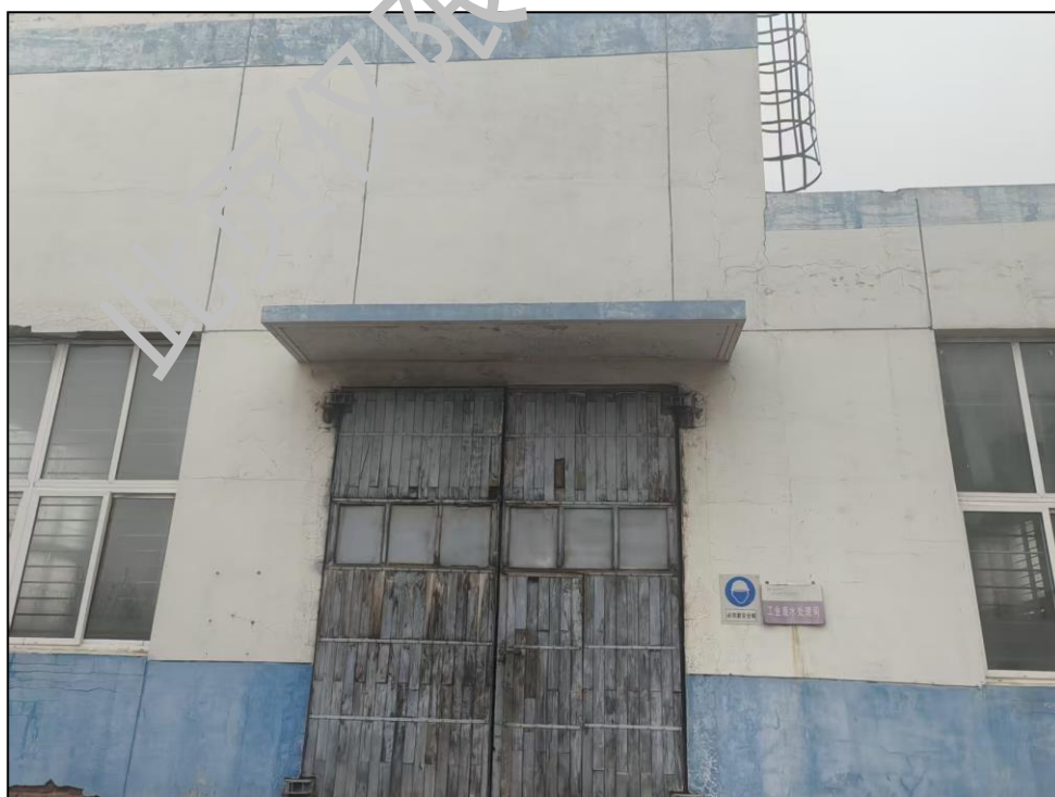
图 3.1.3-2 工业废水处理站
